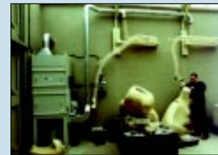
Установка с дополнительной взрывозащитой в мастерской скульптора.
